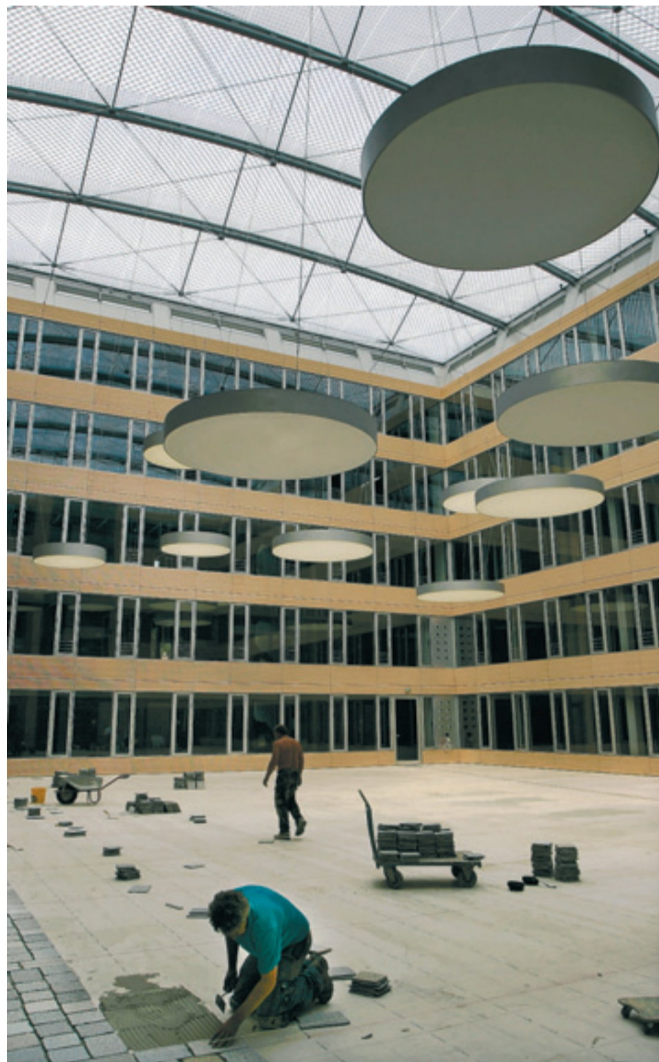
Der Lichteinfall im Innenhof des Neubaus wird pneumatisch reguliert.
